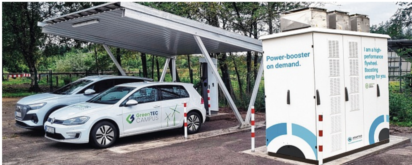
Die Ultra-Schnellladestation auf dem Greentec-Campus in Enge-Sande.
