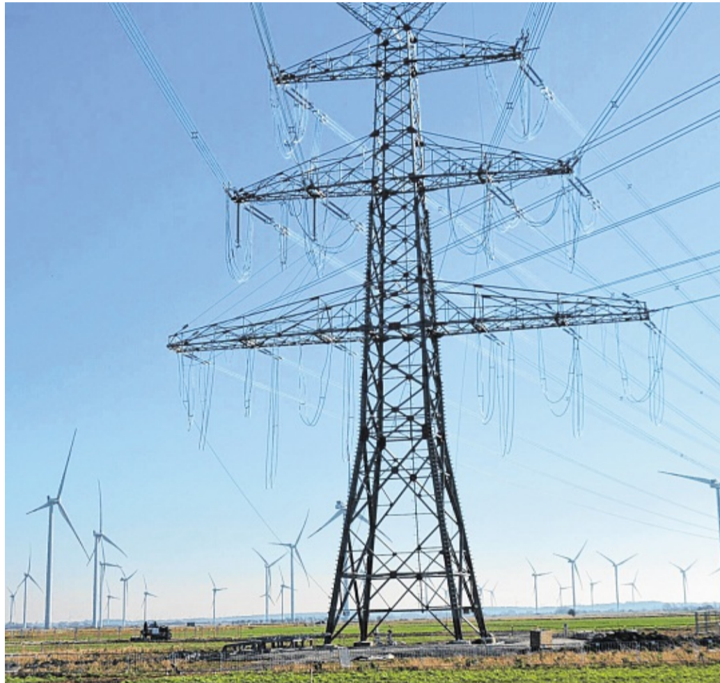
Die Energieversorgung zählt zur kritischen Infrastruktur.
