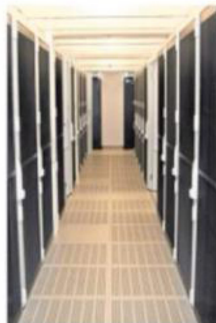
Server-Domizil: Blick ins Rechenzentrum.
