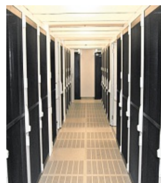
Das Rechenzentrum von Windcloud erzeugt Wärme, ...
